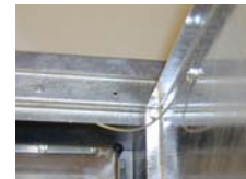
Türseil verhindert überschlagen der Tür
